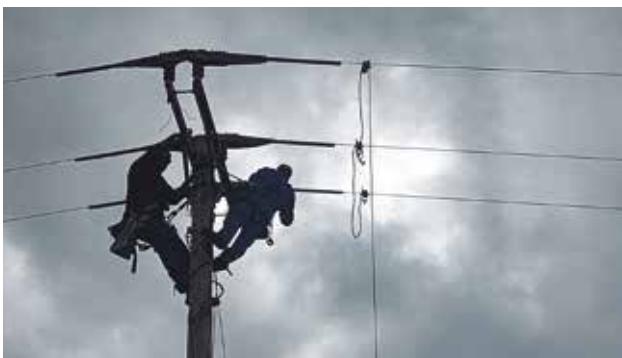
Εικόνα 12: Παράδειγμα τοποθέτησης καλυμμάτων σε μονωτήρες στήριξης πάνω σε ευθύγραμμη τραβέρσα, στην περιοχή του Ρεθύμνου Κρήτης (Σταμάτης Τομαράς©-ΔΕΔΔΗΕ).
