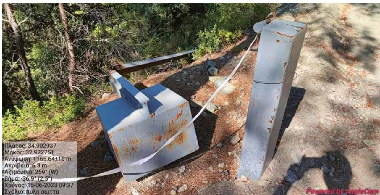
Εικόνα 4: Περίπτωση Σαϊττά, η πύλη καταστράφηκε αποτέλεσμα τραβήγματος με όχημα. Πιθανόν να μετακινήθηκαν οι πάσσαλοι. Με την επανατοποθέτηση της νέας μπάρας, ενδέχεται να υπάρξουν προβλήματα στο κλείσιμο της πύλης. Μιχάλης Ζαχαρία©Αρχείο Τμήματος Δασών.
